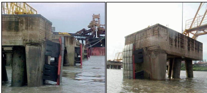
Figura 1: Plataforma D10 do Berço 106 após o impacto
