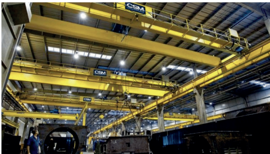
Figura 20: Estruturas implantadas no sistema de pontes rolantes das indústrias
