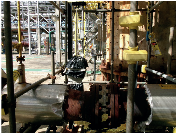
Figura 10 - Valvula FV-430061 item 39 em campo removido.
