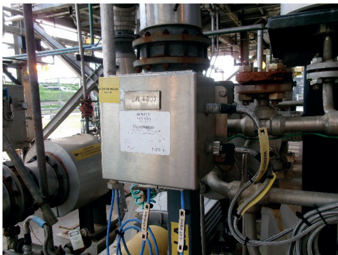
Figura 7 - CJA-4307 e VE-433025A instalados em campo.
