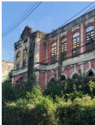
Figura 5.1 – Colônia Juliano Moreira em ruínas
