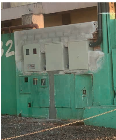
Figura 2 – Entrada de Energia
