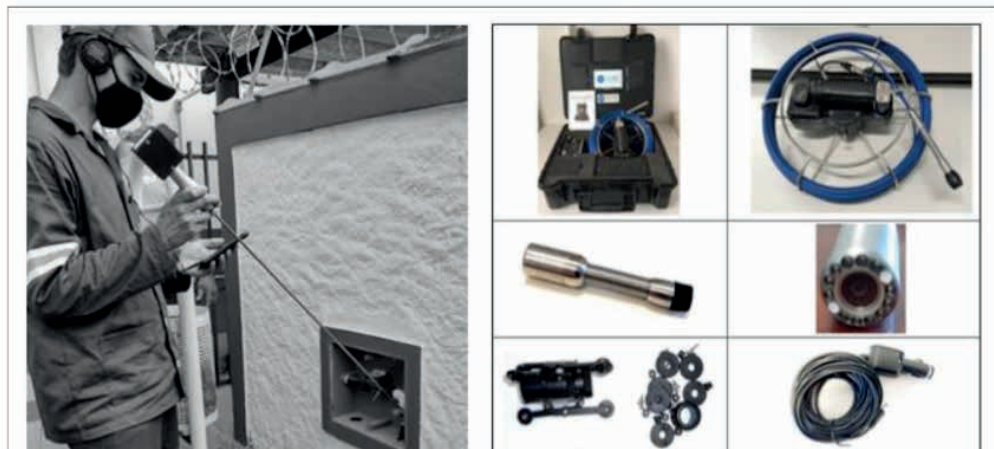
Fig 4 – Pesquisa de vazamentos não visíveis – Sistema automatizado
