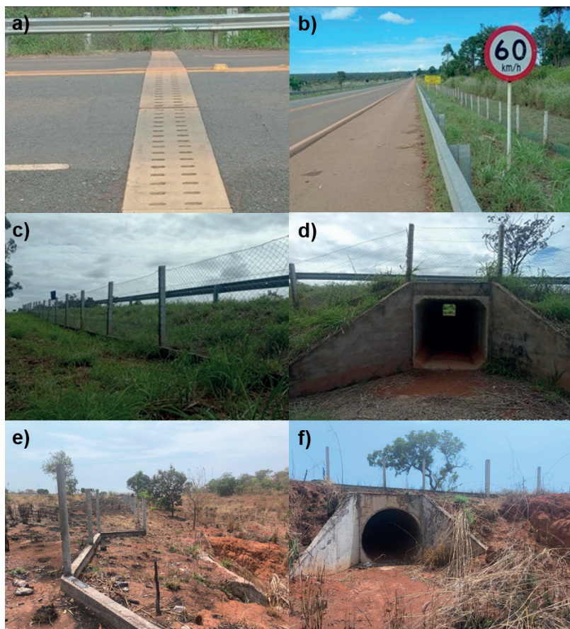
Figura 8 - Estado de conservação das medidas mitigatórias de atropelamento de fauna nos hotspots e corredores ecológicos: a) túnel climático; b) placas de sinalização; c) cerca; d) túnel com cerca; e) cerca vandalizada e deteriorada; f) túnel com cerca vandalizada e deteriorada.
