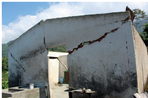
Imagen 10. Vivienda de El Plan, colapsada
