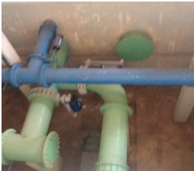
Figura 5: Sistema de filtração utilizado pelo DMAE
