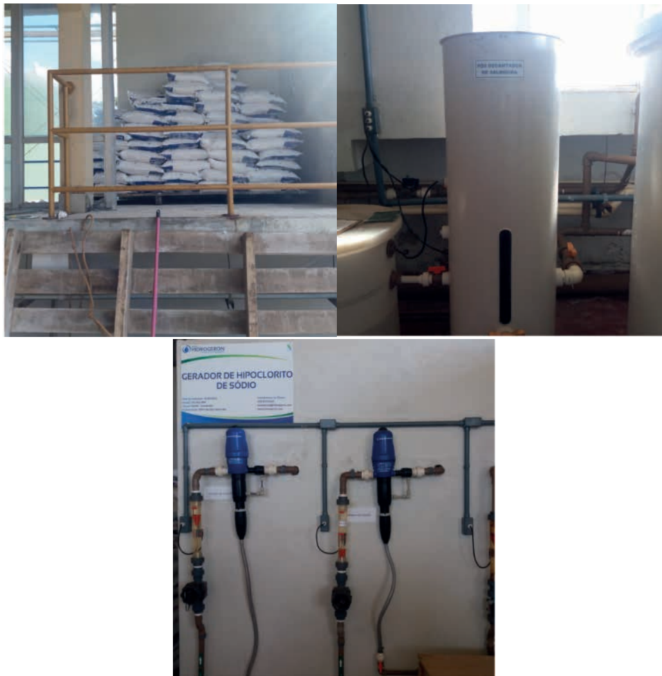
Figura 7: Sistema de purificação do hipoclorito de sódio
