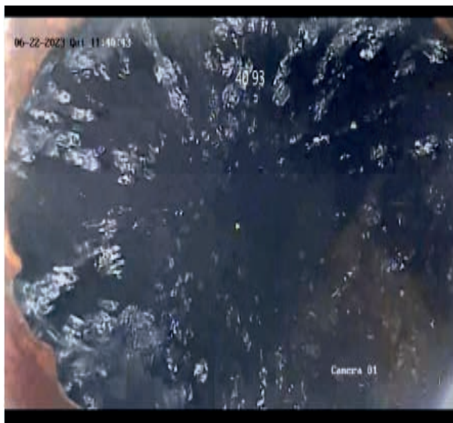
Figura 7: mostra vazamento aos 41 metros de profundidade.
