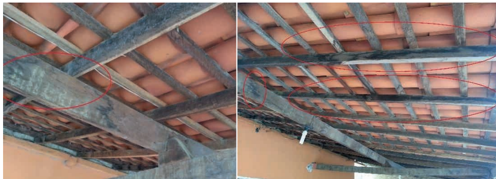
FIGURA 4. Manchas de humedad
