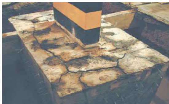
Figura 3 - Detalhe de fissuras mapeadas no topo de um bloco de fundação (Andrade, 2006).
